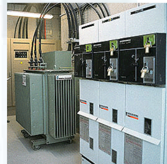
Poste de transformation HT/BT
